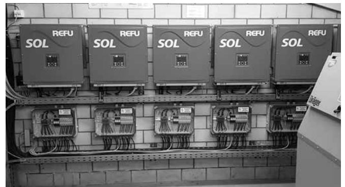
Wechselrichter im Technikraum
